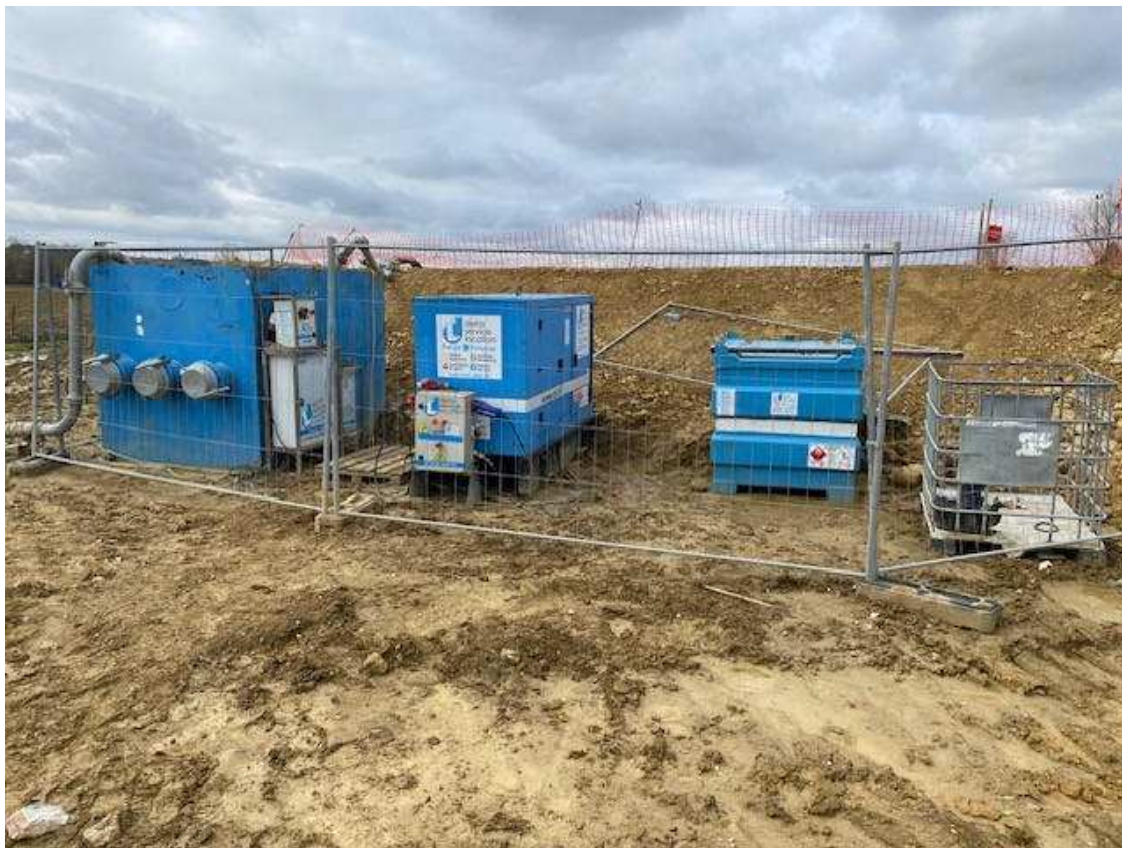
Groupe électrogène alimentant la pompe et benne de filtration
