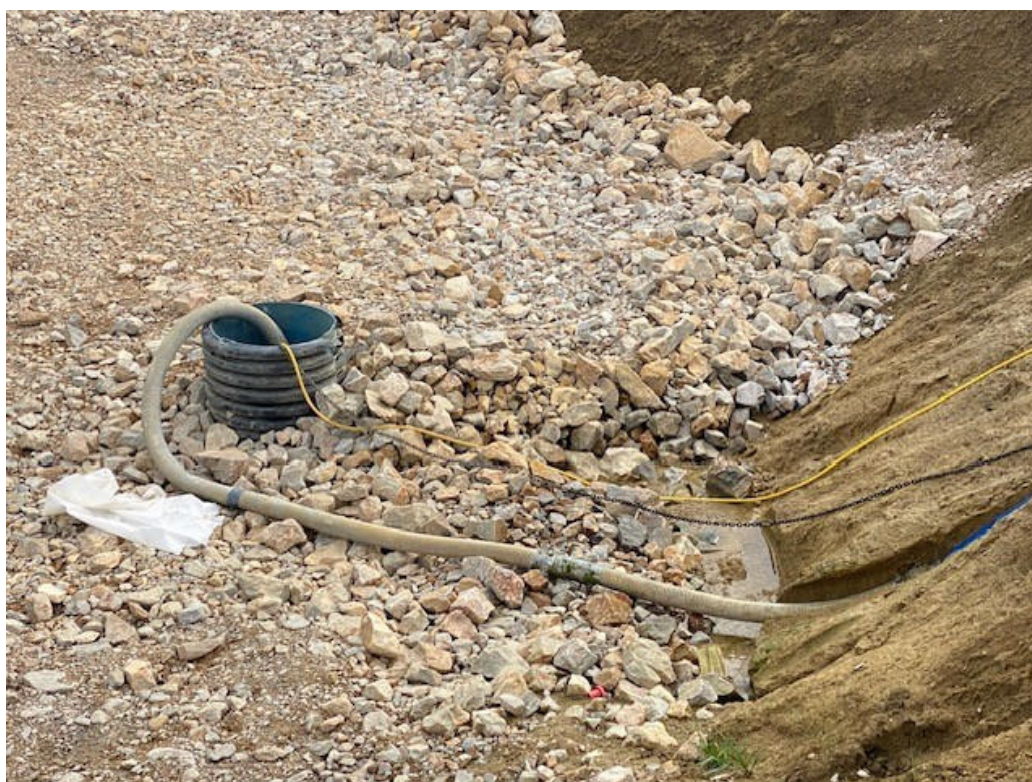
Pompe positionnée dans la buse verticale en fonctionnement par intermittence
