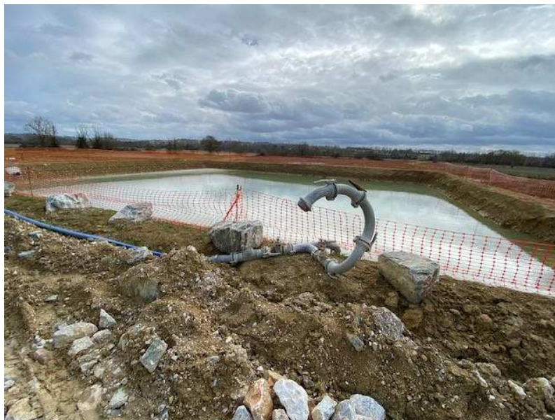
Rejet du bassin d'infiltration/décantation avec système de branchement pour tonne à eau
