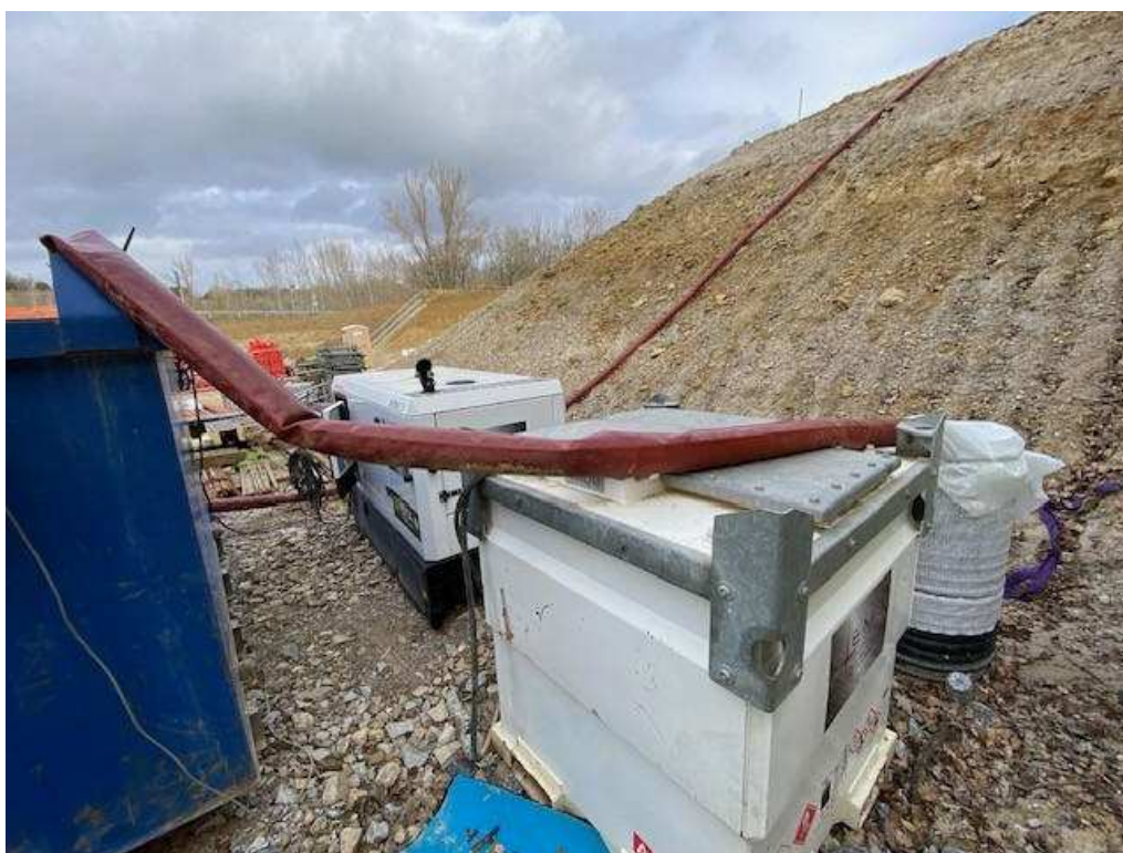
Seconde pompe positionnée dans la buse verticale en fonctionnement par intermittence ne disposant pas de compteur volumétrique
