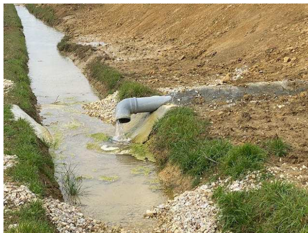
Rejet du bassin d'infiltration/décantation vers le milieu naturel attestant du fonctionnement de la pompe
