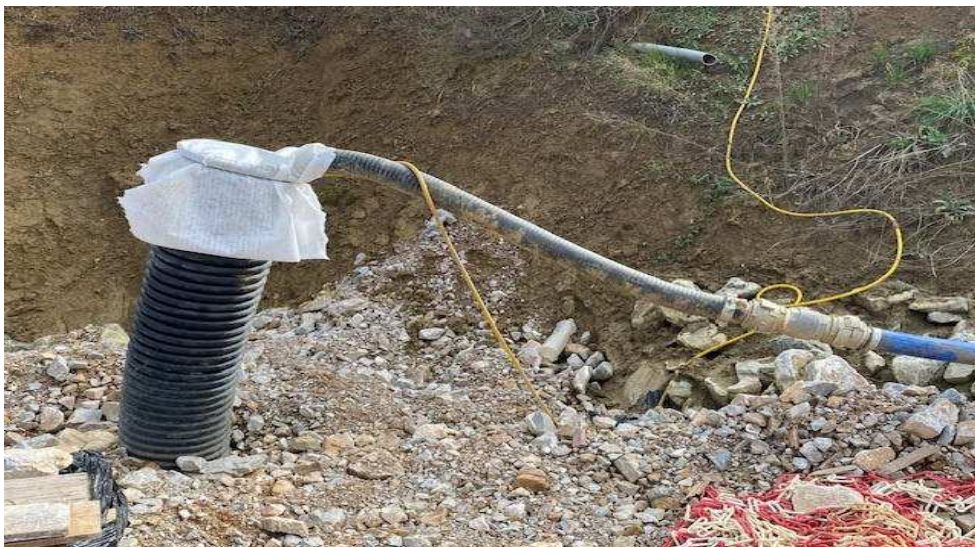
Pompe positionnée dans la buse verticale en fonctionnement par intermittence
